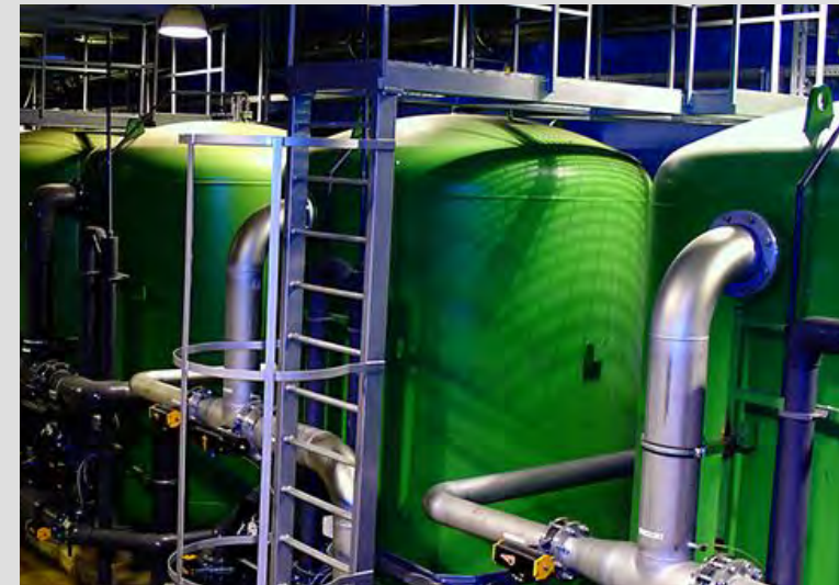
PLANTA DE TRATAMIENTO DE AGUAS CON RECUPERACIÓN DE EFLUENTES
